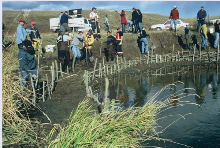
La construction de barrières de fascines dans le ruisseau West Nose. Les outils et les techniques de génie biologique sont assez simples, mais le processus peut demander beaucoup de main d'œuvre.
